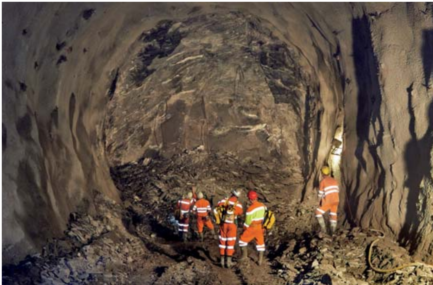
DER DRANG NACH SÜDEN: IMMER WEITER BOHREN UND SPRENGEN SICH DIE MINEURE BIS ZUM DURCHBRUCH DES TUNNELS.
