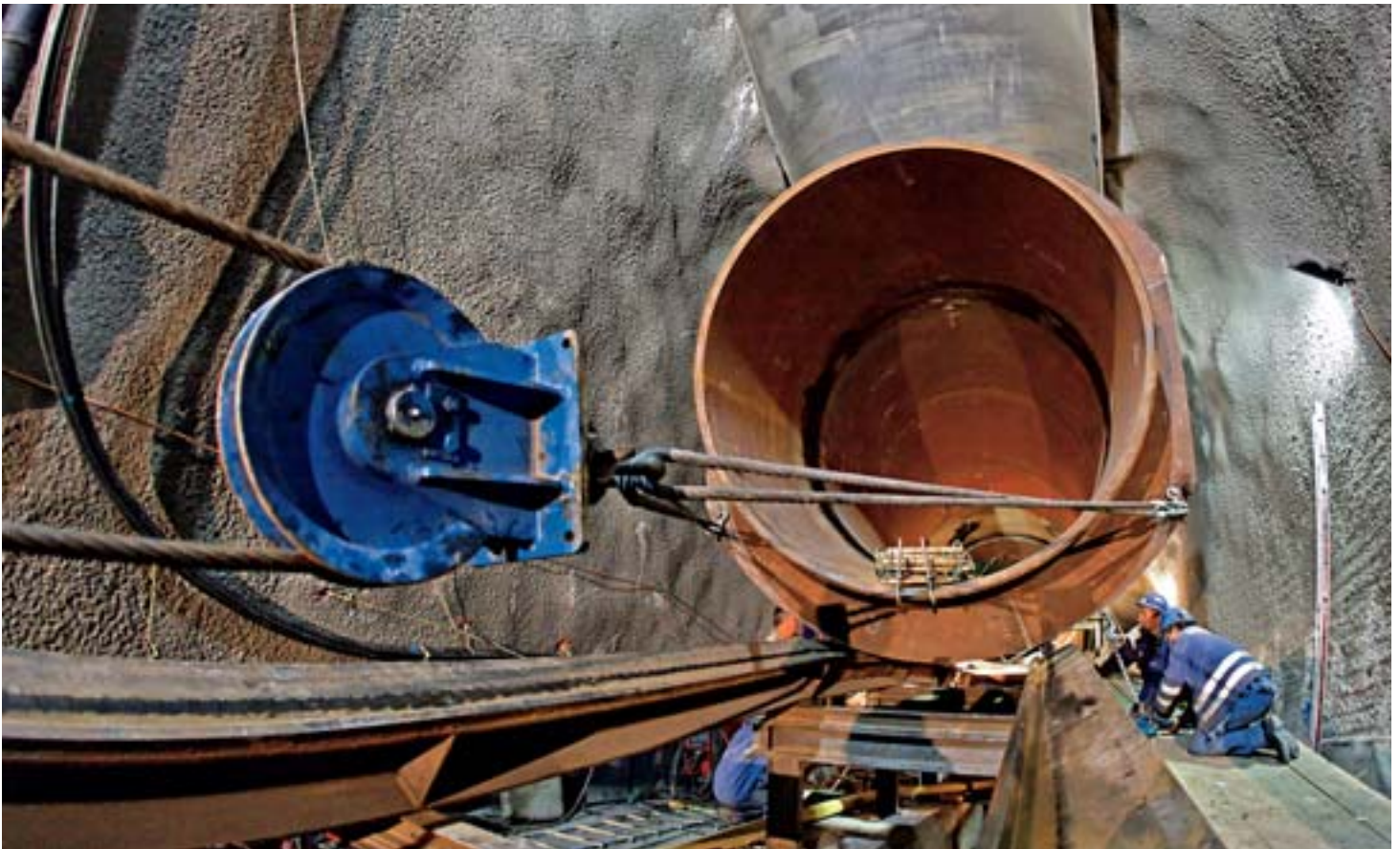
MIT SEIL UND HAKEN: LANGSAM LASSEN DIE SPEZIALISTEN EIN ELEMENT IN DEN SCHRÄGSTOLLEN GLEITEN.
