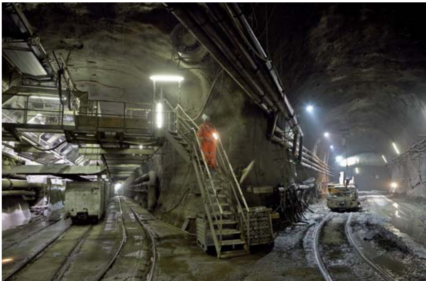
LINKS DER TUNNEL, RECHTS EIN VERBINDUNGSSTOLLEN. ER WIRD ZURÜCKGEBAUT, WENN DIE TUNNELRÖHREN KOMPLETT SIND.
