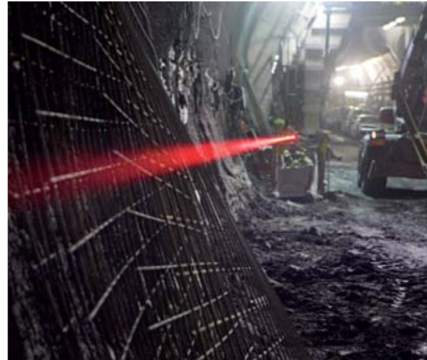
MIT HILFE DES LASERSTRAHLS BLEIBEN DIE TUNNELBAUER EXAKT AUF DEM RICHTIGEN KURS.
