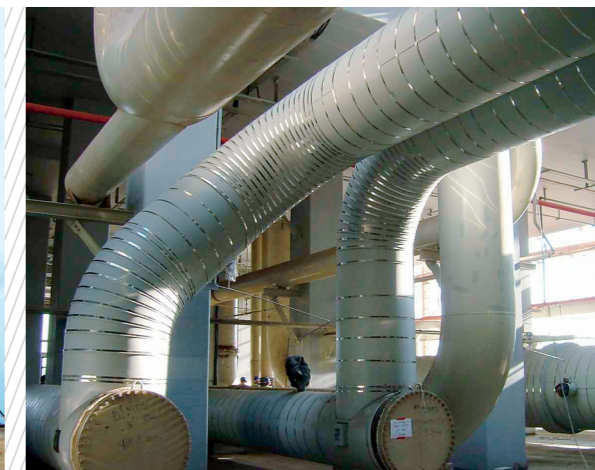
EINE SPEZIALISOLIERUNG GLEICHT TEMPERATURUNTERSCHIEDE BIS 200 GRAD CELSIUS AUS.
